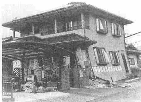
【倒れかかっている家】
